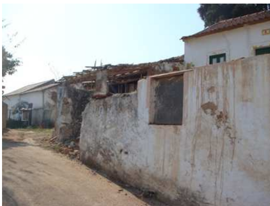
Imóvel degradado (demolido)
