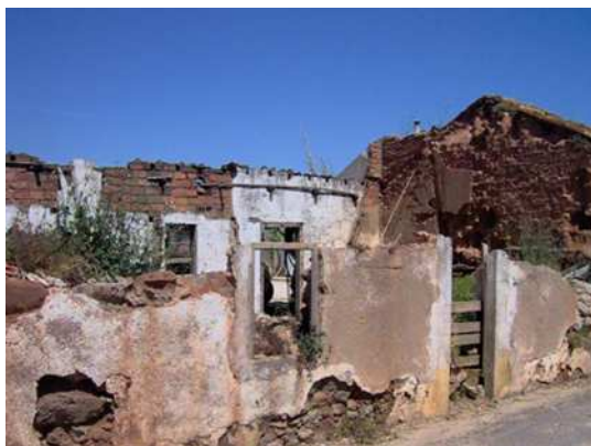
Imóvel degradado (demolido)
