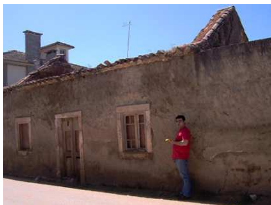
Imóvel degradado (recuperado)
